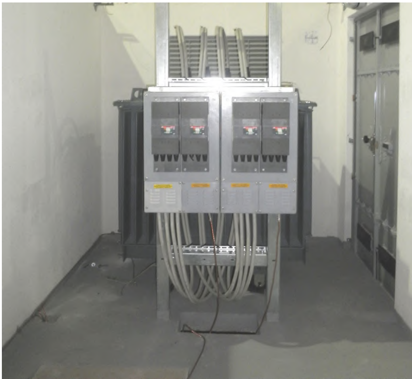
Esempio quadro BT installato
